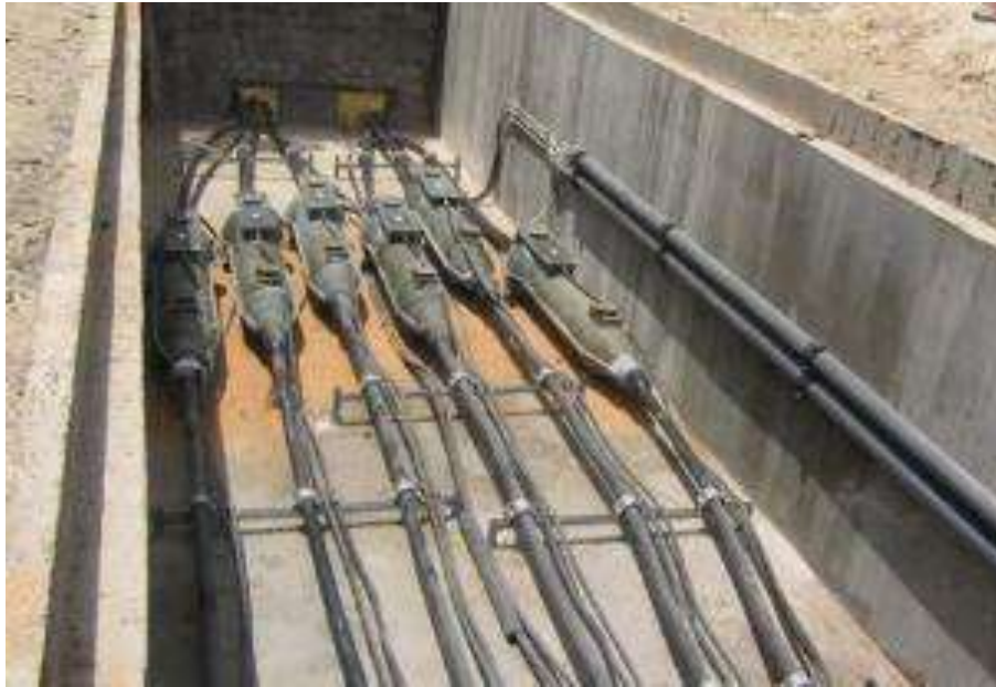
Ejemplo de arqueta de conexión. Fuente: Centaur.
